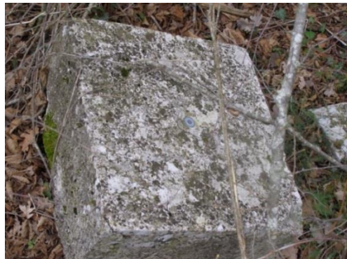
Slika 13: Točka 261 Oržin – odvaljeni gornji dio stabilizacije.
